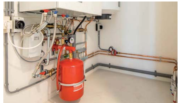
△ Eén woning wordt verwarmd en geventileerd door ventilatiewarmtepomp Ecolution, met elektrische boiler.
