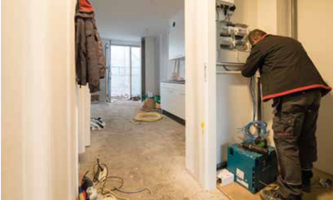
Een installateur brengt de nieuwe installatie aan in een van de NOM-woningen.
